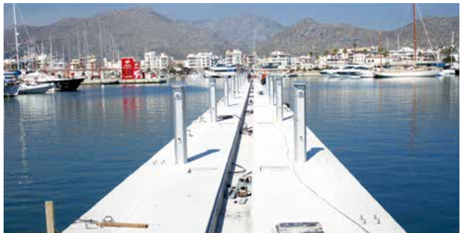
Arriba, el alargamiento del espigón; abajo, nueva instalación de electricidad. Fotos: R. B y R. Collado.
