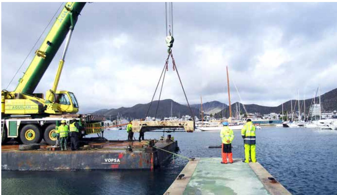
Los operarios procediendo a la demolición de una losa antigua con la ayuda de maquinaria. Foto: R. Collado.
